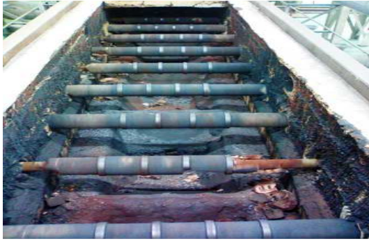
ภาพที่ 12 ลูกกลิ้งและฉนวนความร้อนในเตาอุโมงค์
